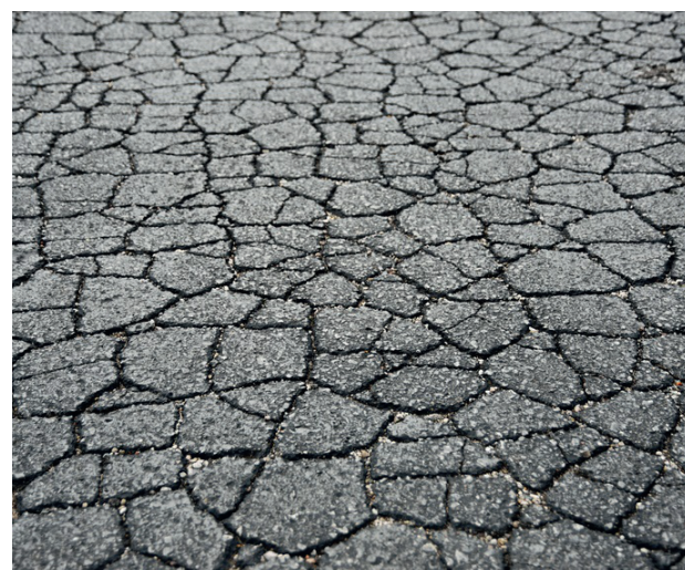
7. ábra Aszfaltfelület hálós repedése
