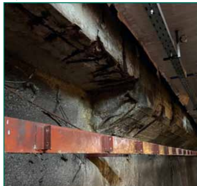
1. kép: Rejtett szerkezeti hibák
