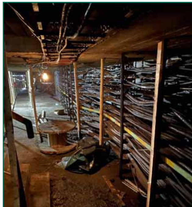
2. kép: Azonosításra váró kábelköteg
