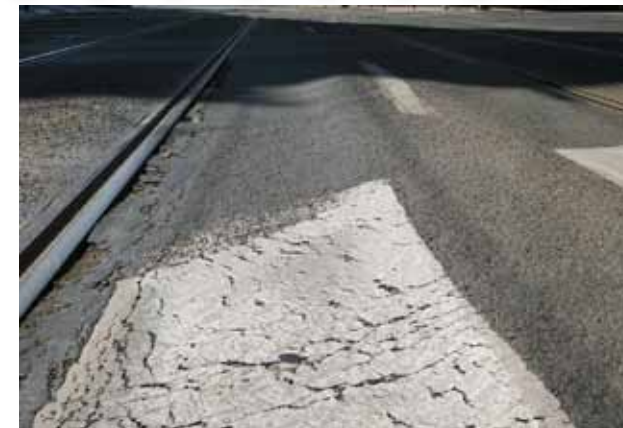
5. kép: nyomvályúsodás és a sinszál melletti károsodások az Anna-kúti csomópontonál
