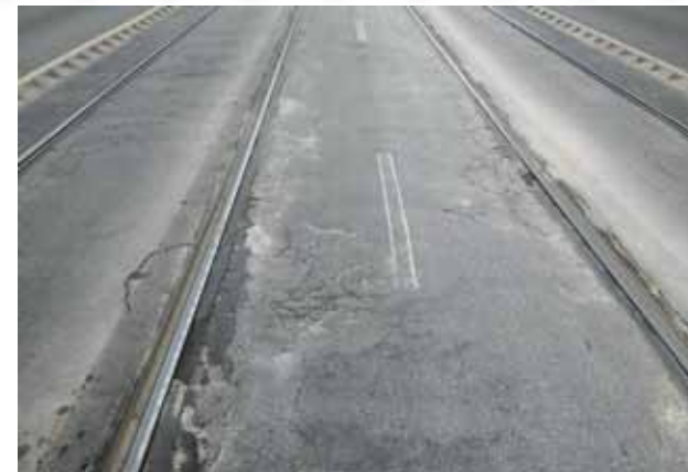
4. kép: a sinszál-burkolat kapcsolatból kiinduló burkolati hibák Budapesten, a Múzeum körúton
