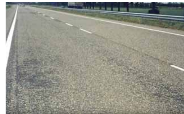
1. ábra: Bitumen öregedése következtében létrejött kipergés
