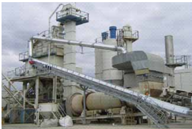
2. ábra. Kiépített recycling rendszer a Dunaharaszti gépen
